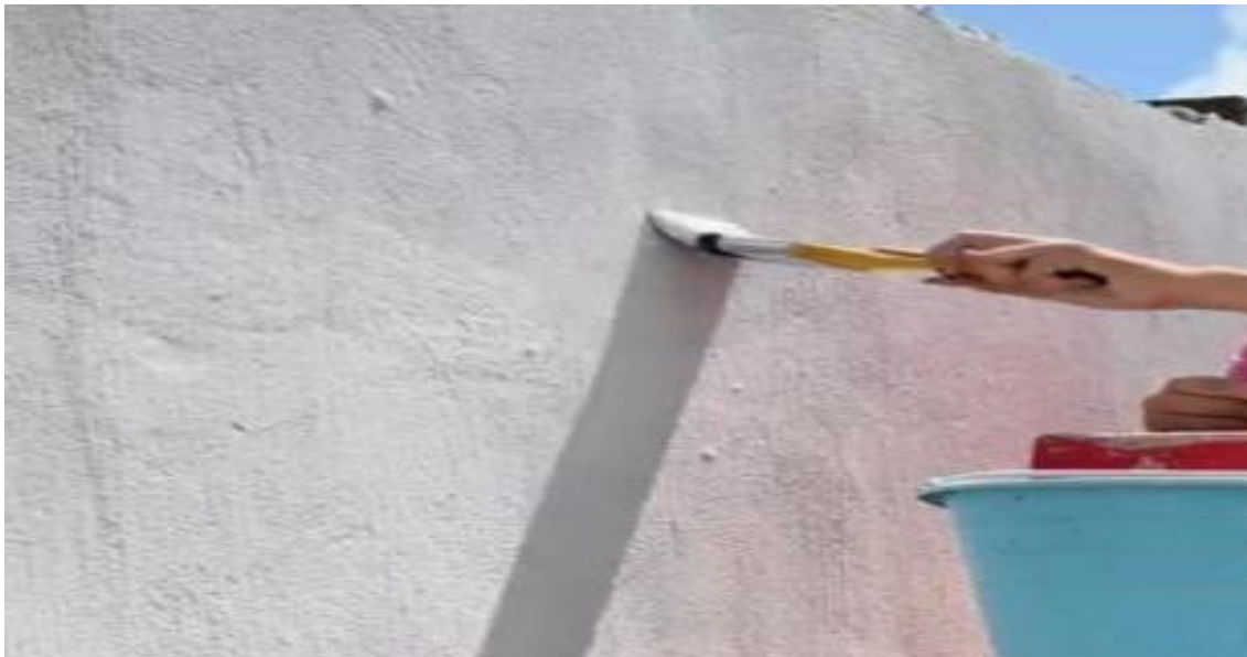
Figura 2. Pared exterior con alta radiación solar
